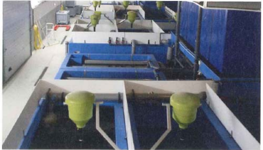
Blick in Sachsens erste mit Biogas beheizte Fischzuchtanlage.
