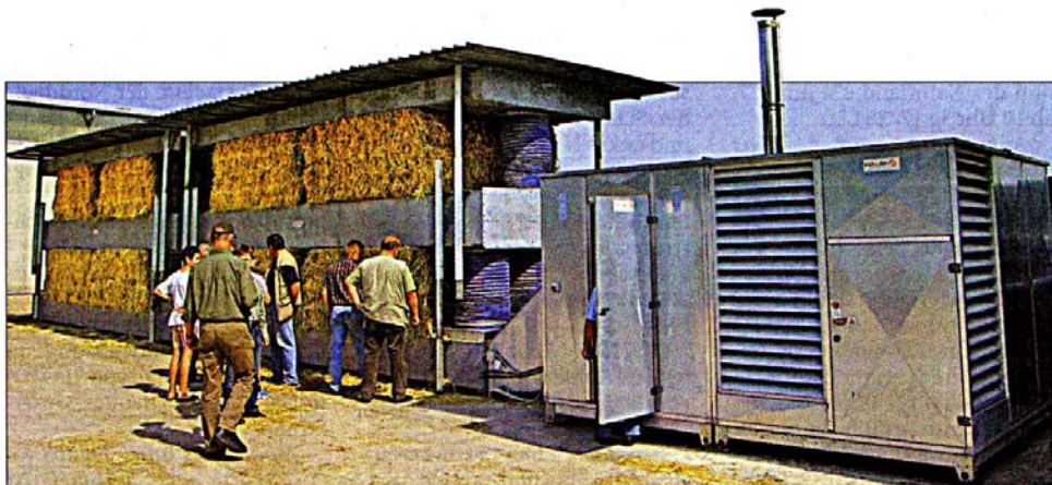
DIE TROCKNUNGSANLAGE für Quaderballen wurde genau unter die Lupe genommen.
